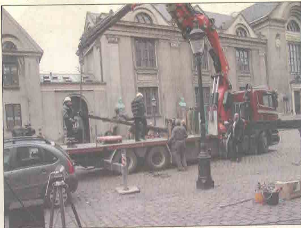
København: På sydsiden af Vor Frue kirke skal skulpturen stå på tre meter høje søjler
